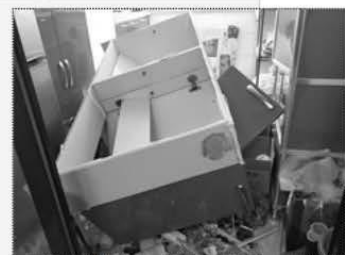
厨房吊柜坠落
