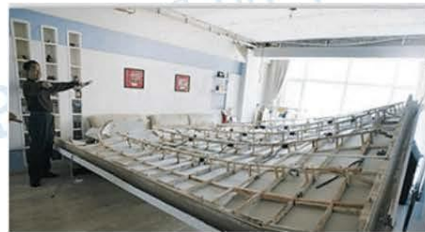
展示厅的吊顶脱落
